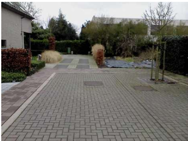
Aansluiting op de Weverstraat. Rechts achteraan het braakliggend terrein. Op de achtergrond de gemeentelijke loods.
