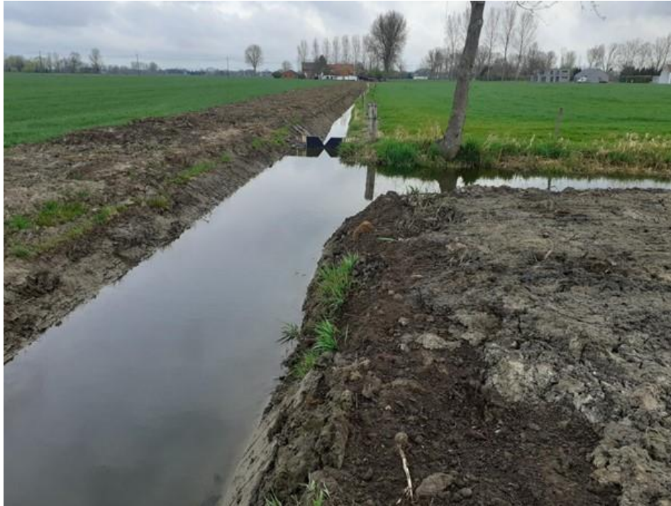
Figuur 14. Voorbeeld van stuw geplaatst in Beveren op gracht van algemeen belang van Heirbaan naar Melselestraat.
